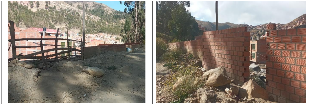
Fuente: Inspección en campo, 2023
